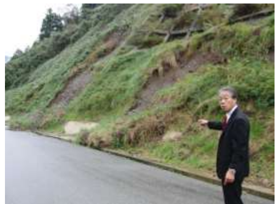
2013.10.24.時点のコースのり面崩落の写真
